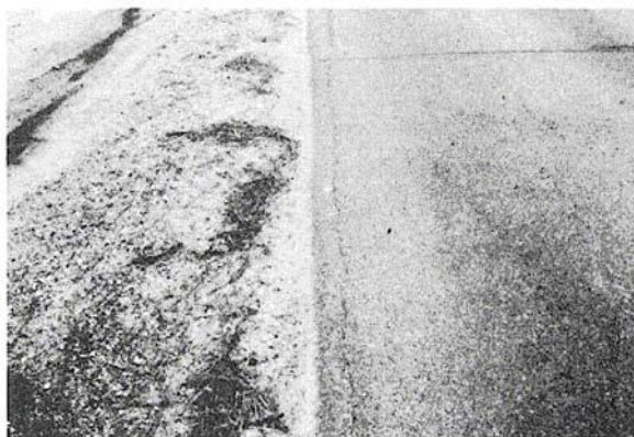
Figura B-7.a. Agrietamiento de Borde Baja-severidad.
