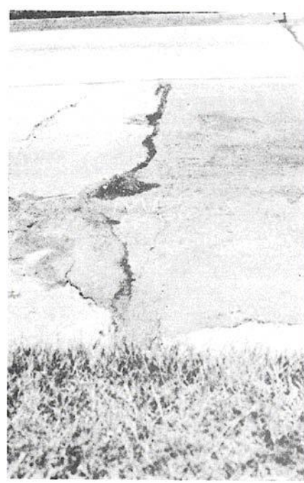
Figura -1.b. Hinchamiento / Pandeo Media-severidad.
