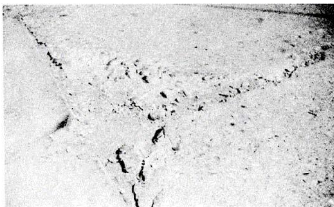
Figura C-18.c. Escamadura de Esquina Alta-severidad.
