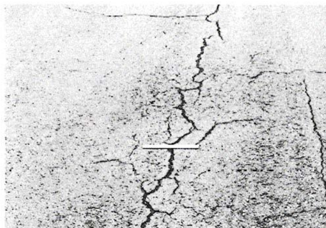
Figura B-10.b. Agrietamiento Longitudinal y transversal Media-severidad.
