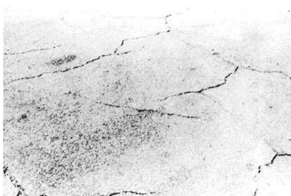
Figura B-3.a. Agrietamiento en bloque Baja-severidad.
