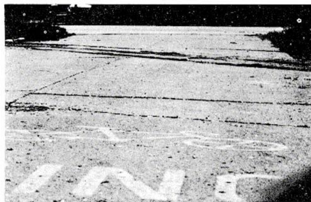
Figura C-15.b. Cruce de Ferrocarril Media-severidad.
