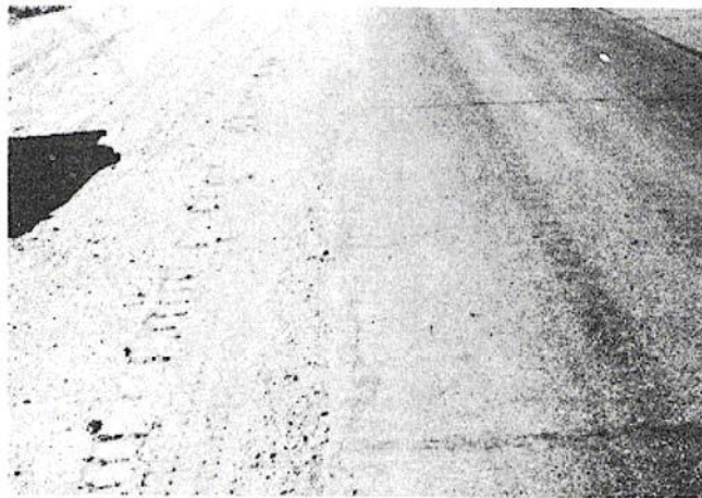
Figura B-8.a. Agrietamiento Reflejo de Juntas Baja-severidad.
