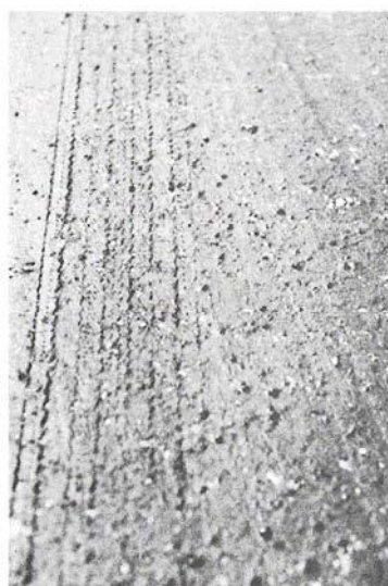
Figura B-2.c. Exudación o Sangrado Alta-severidad.
