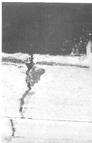
Figura C-8.b. Agrietamiento Lineal Media-severidad.
