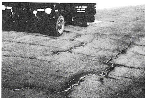
Figura B-3.c. Agrietamiento en bloque Alta-severidad.
