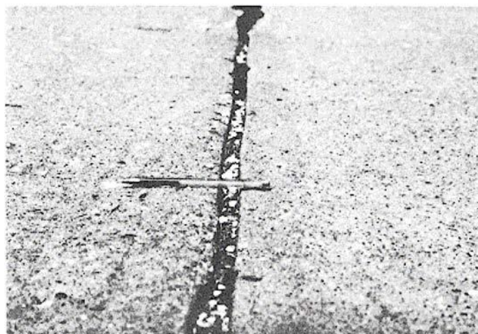
Figura C-6.c. Daño del Sello de Junta Alta-severidad.
