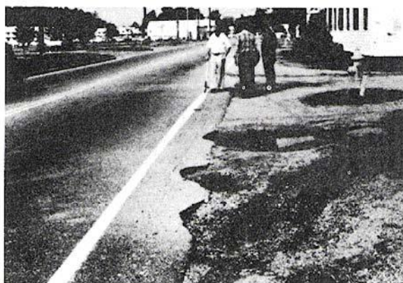
Figura B-7.c. Agrietamiento de Borde Alta-severidad.
