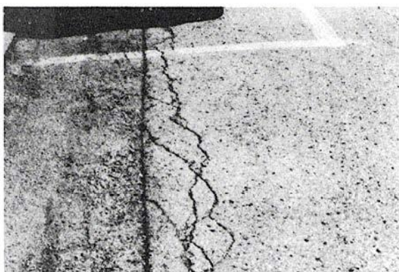
Figura B-7.b. Agrietamiento de Borde Media-severidad.
