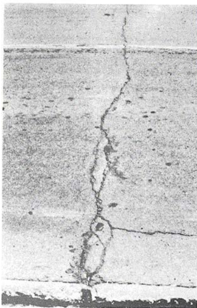
Figura B-8.b. Agrietamiento Reflejo de Juntas Media-severidad.
