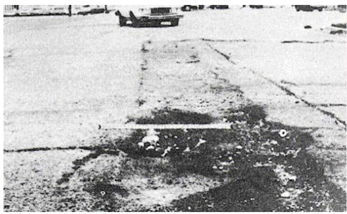
Figura B-11.c. Parchados Alta-severidad.
